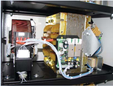
Тороидальный регулятор напряжения, вольтодобавочный трансформатор
